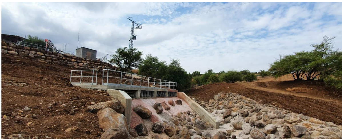
איור 5. מתקן שחרור המים בנחל צלמון (צילום: עידן ברנע)
